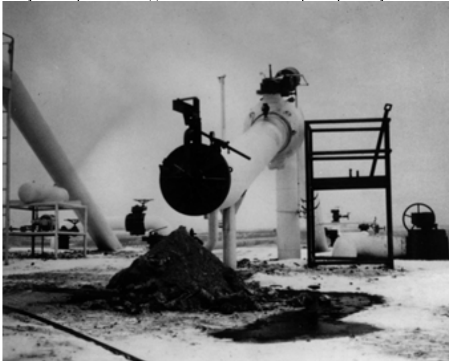
Рис. 1. Образование гидратов в газопроводе
